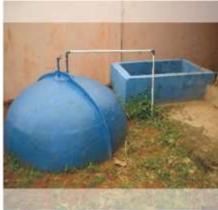
Gambar 25. Instalasi biogas dari feses dan urine sapi.
