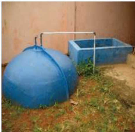
Gambar 42. Instalasi biogas dari ternak sapi penghasil slurry .
