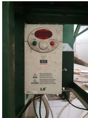
Gambar 3.27. Inverter Motor AC untuk mengatur berapa putaran feed burner .
