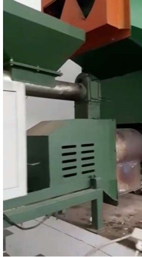
Gambar 3.26. Komponen burner sebagai pemanas dari rotary dryer .
