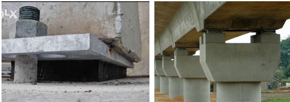
Gambar 28. Elastomeric Bearing Pad pada jembatan Sumber : Trinity (2016)
