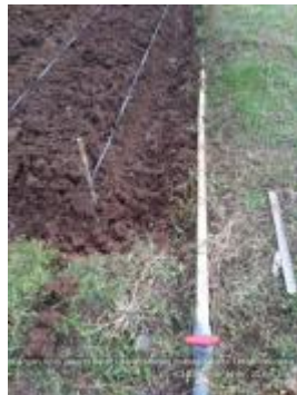
Gambar 3. Pipa saluran air
