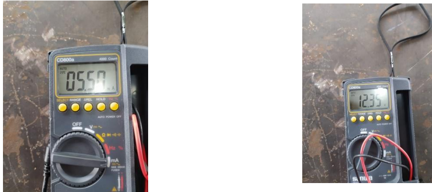
Gambar 4.8 Pengujian Kebutuhan Listrik pintu air terkendali
