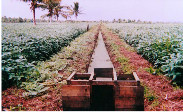
Gambar 4. Sistem pengelolaan air dengan menggunakan pintu pengendali air (stoplog) di lahan rawa pasang surut (Dok.Anwar dan Alwi, 2014)
