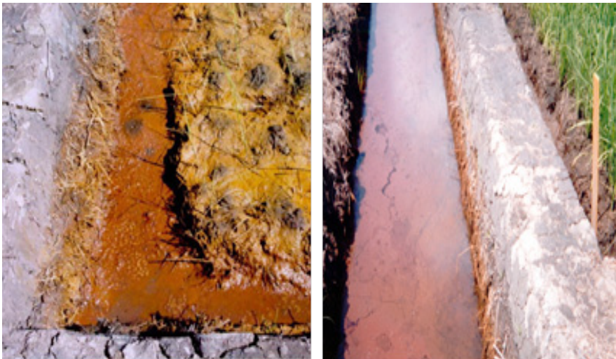
Gambar 3. Karat besi pada saluran air drainase di persawahan lahan sulfat masam (Dokumen : Anwar, 2006)
