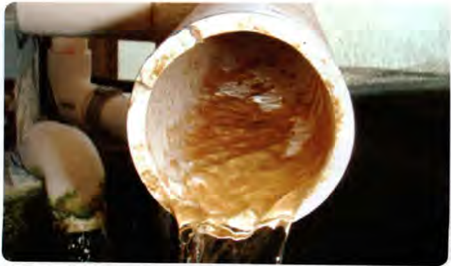
Tumpukan biofilm pada pipa dapat menjadi sumber penyakit
