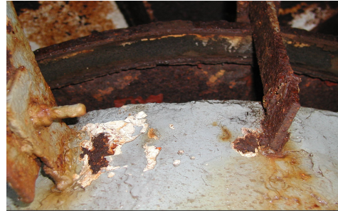
Gambar 7 Ventilasi dan gasket rusak dan berkarat
