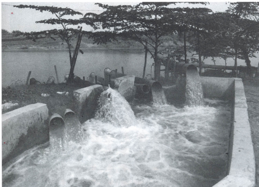
Gambar 6.9. Pompa sentrifugal sedang operasional
