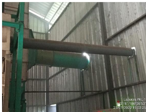
Gambar 20. Pipa pembuangan asap pembakaran
