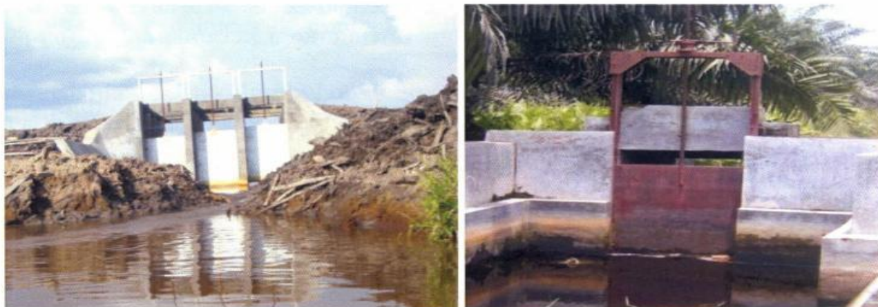
Gambar 14. Model pintu air pada saluran sekunder (kiri) dan saluran tersier (kanan) (Dok. M. Noor/Balittra)
