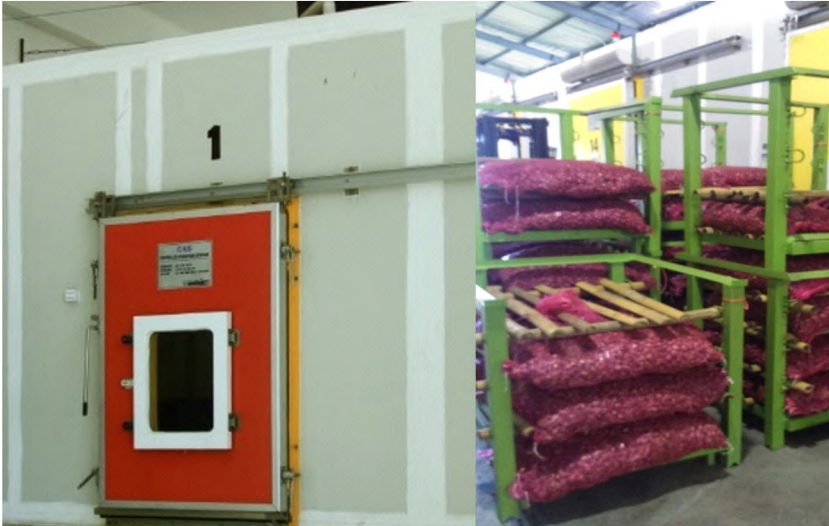
Ruang penyimpanan dengan sistem CAS
