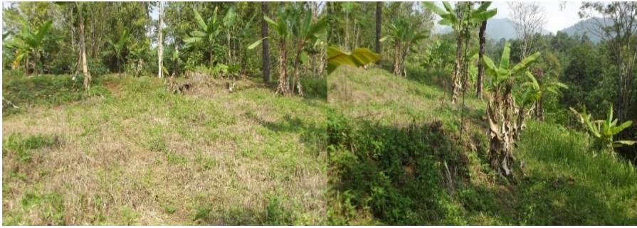
Gambar 1. Kearifan lokal nyabuk gunung atau penterasan sudah banyak yang tidak terurus, banyak runtuh
