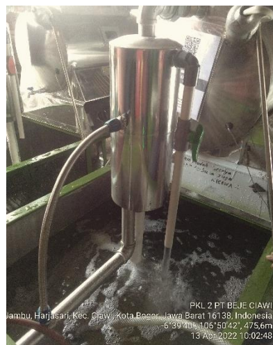
Gambar 15 : Pengecekan fungsi pendingin dan pompa air
