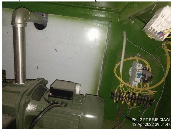
Gambar 20 : pengecekan fungsi instrumen elektronik dan solenoid valve (Sumber : Dokumentasi pribadi di PT BEJE)
