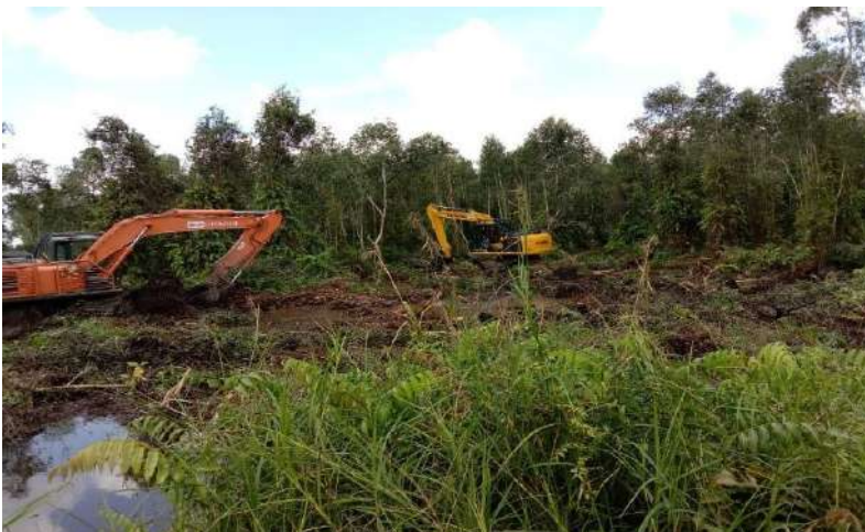
Gambar 4.4. Proses Land Clearing Pada Kegiatan Cetak Sawah Kementerian Pertanian Republik Indonesia | Capaian Kinerja
