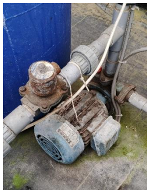
Gambar 12 Pompa Air Sumber : Dokumentasi Pribadi
