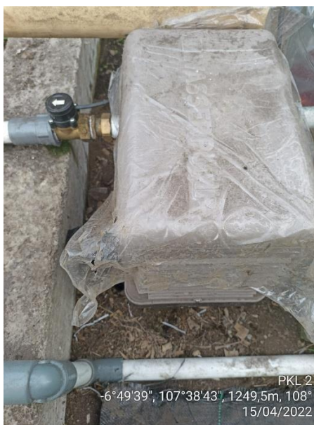
Gambar 9. Dokumentasi Pompa Air
