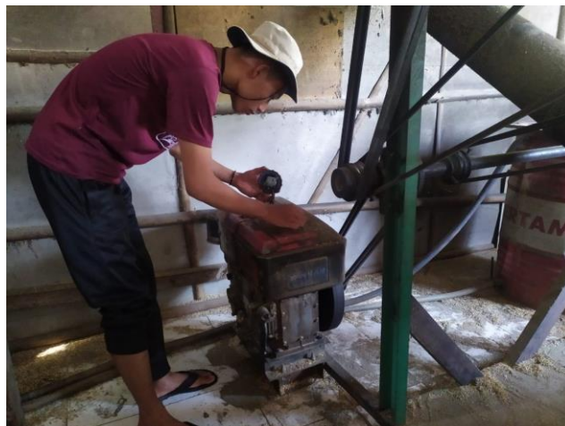
Gambar 17. Pengecekan motor penggerak
