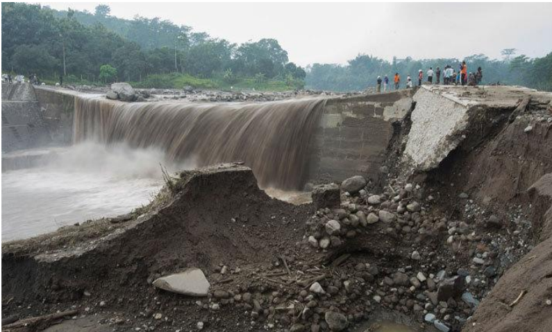
Gambar 12. Lahar hujan dari Gunung Kelud (sumber: Antara Foto, Februari 2014)
