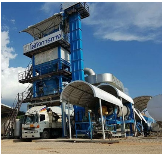
Gambar 12. Mesin AMP yang tidak bergerak (stationary)
