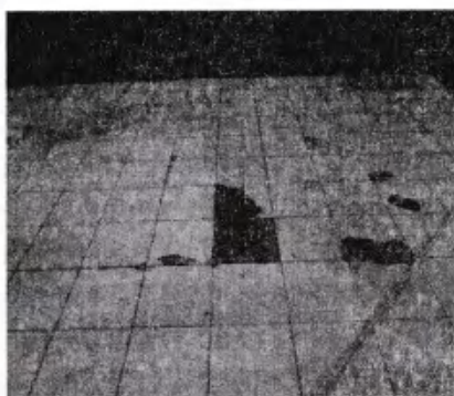
Lantai ruang penyembelihan licin dan tidak rata
