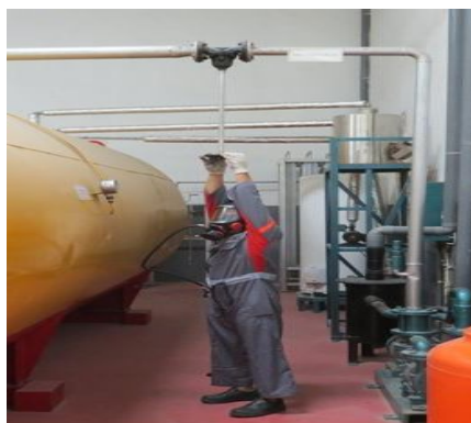
Gambar 15 Pembukaan katup saluran pompa vakum
