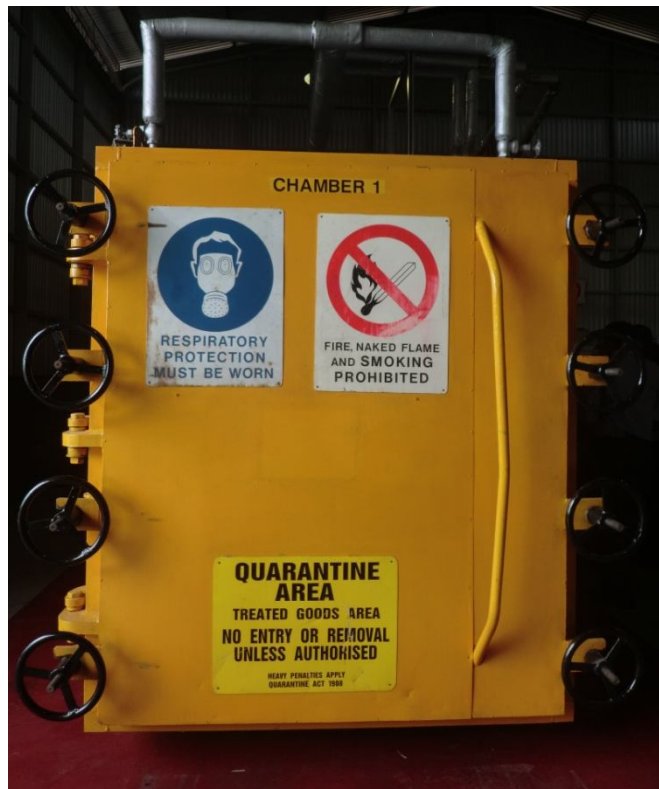
Tanda bahaya pada pintu chamber
