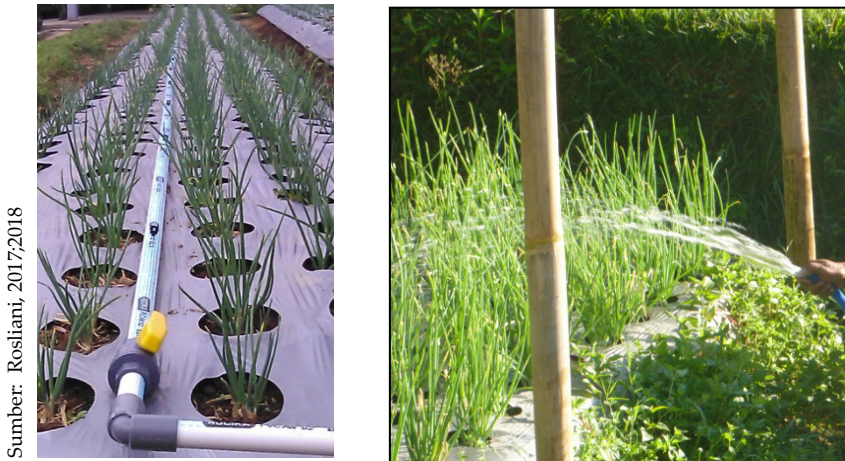
Gambar 22. Instalansi irigasi selang plastik menggunakan nozzle dengan semprotan air 360°
