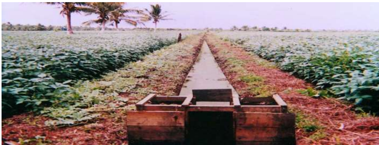
Gambar 4. Sistem pengelolaan air dengan menggunakan pintu pengendali air (stoplog) di lahan rawa pasang surut (Dok. Anwar dan Alwi, 2014)
