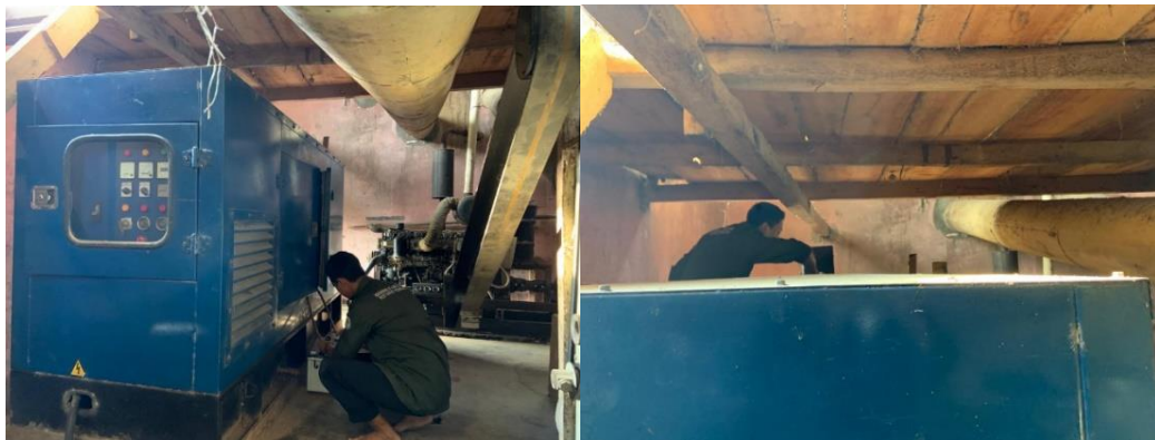
Gambar 4. Pemeriksaan pada generator
