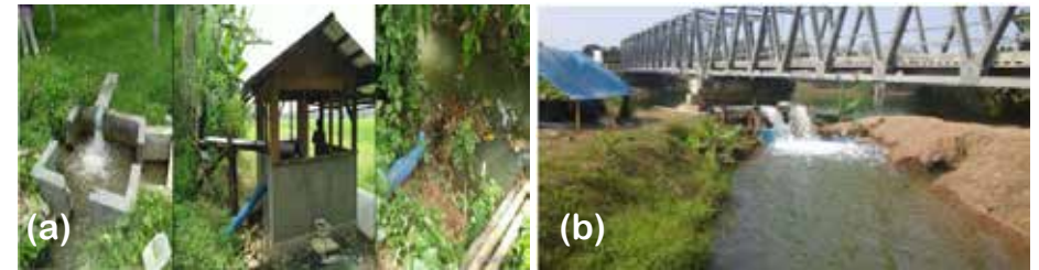
Gambar 21. Pemanfaatan air sungai melalui pompanisasi: (a) Pompanisasi Saluran Sekunder Pusakanegara, untuk irigasi di Kab. Indramayu (b) Pompanisasi S. Ciliuk, Desa Jaro, Kab. Tabalong, Kalsel.
