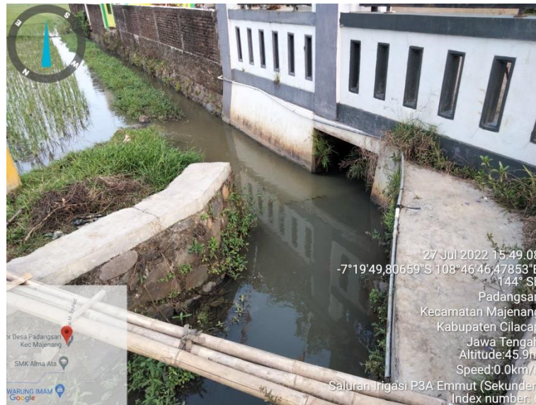
Gambar 13. Saluran Drainase (Saluran Pembuang)
