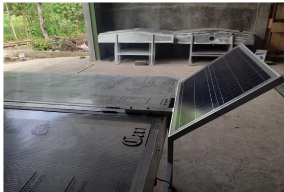
Gambar 16. Dudukan Solar Panel
