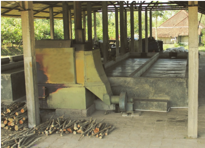
Gambar 16. Pengering mekanis dengan bak dari beton
