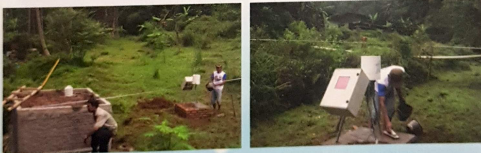
Gambar 4. Dokumentasi pemasangan AWLR di DAS Cisukabirus
