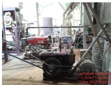
Gambar 41. Mesin penggerak pada RMU
