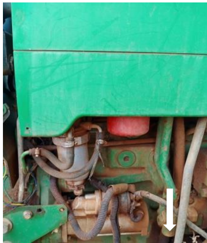
Gambar 15. Bagian kabel listrik
