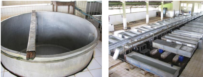
Gambar 16. Bak/tangki penyaringan dan tangki koagulasi pada pengolahan lateks
