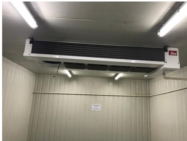
Gambar 10. Kondisi Bangunan Cold Storage BBPP Lembang
