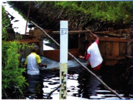
Gambar 5. Pintu air di Demplot ICCTF di Kalimantan Tengah.
