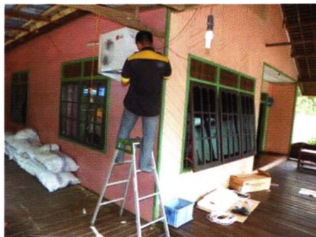
Gambar 14. Satu unit AC terpasang di ruang operasional GC mobile.
